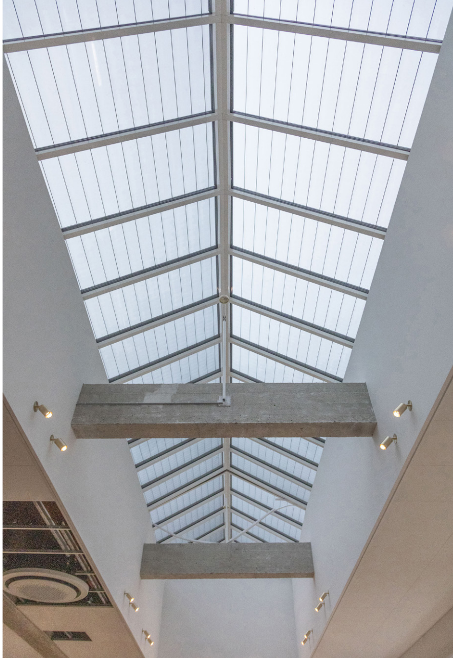
Ovenlyset på ejendommen Lersø Parkallé 101 efter renovering med MicroShade® RW lameller.
